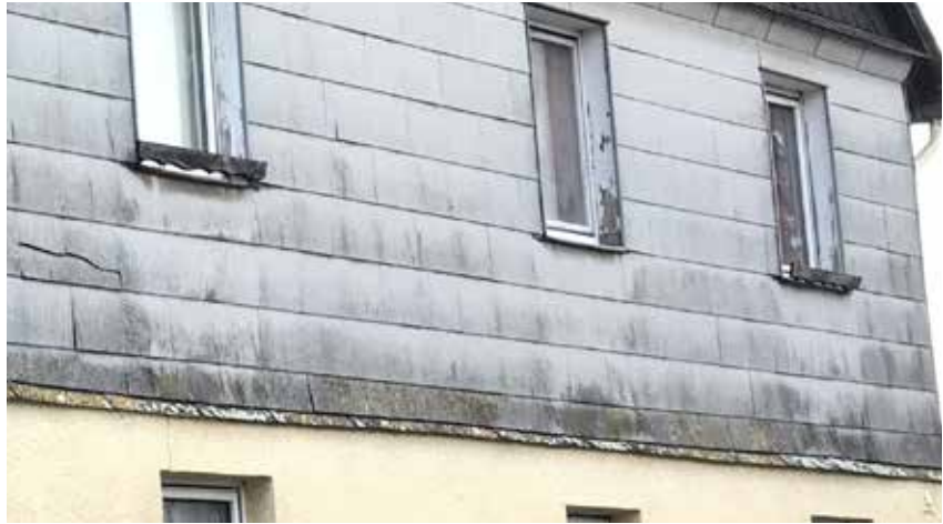
Modernisierungs- und Instandsetzungsbedürftiges Gebäude mit mittlerem Bedarf
