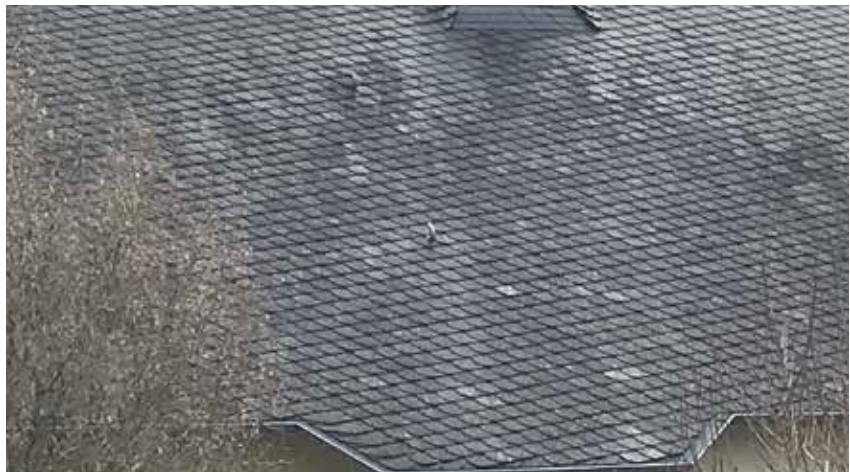
Modernisierungs- und Instandsetzungsbedürftiges Gebäude mit geringem Bedarf
