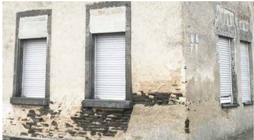
Modernisierungs- und instandsetzungsbedürftiges Gebäude mit hohem Bedarf
