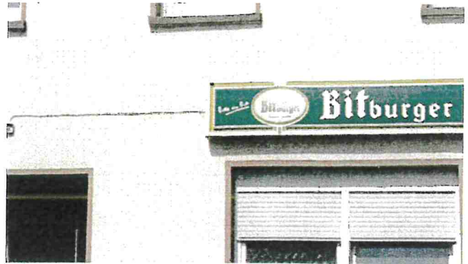
Negativ: Werbeanlagen mit offenliegenden Kabeln
