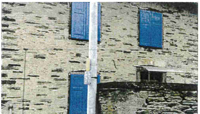
aufdringliche Farbgebung (Fensterrahmen, Klappläden)
